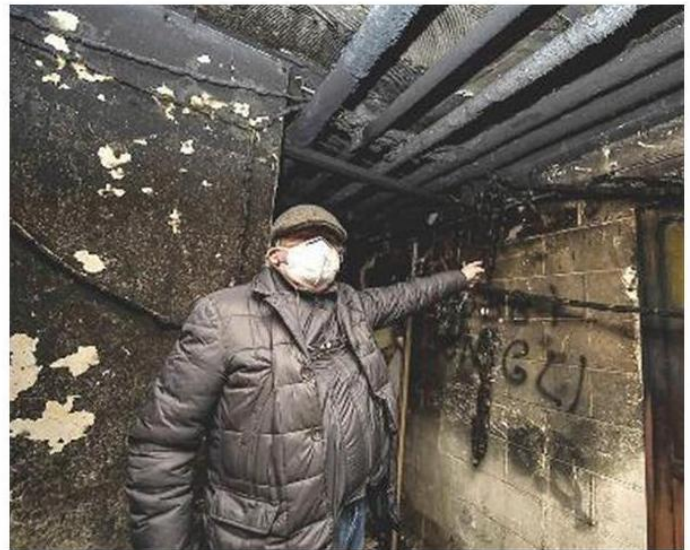
Un residente mostra parte degli ingenti danni alla struttura
