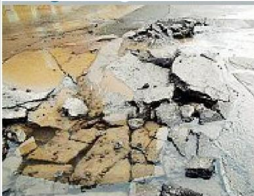
L'asfalto La strada rotta e allagata dopo l'incidente (Gerace)
