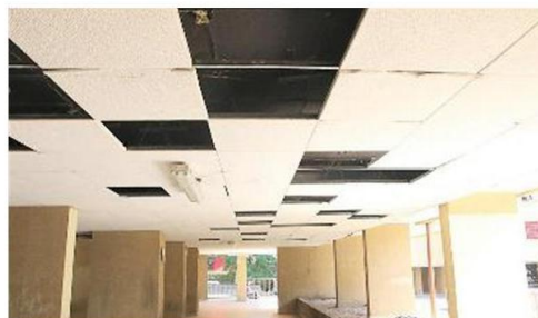
LA SCACCHIERA Lo stato dei controssoffitti del porticato, con molti pannelli mancanti. Rubati o rotti?
