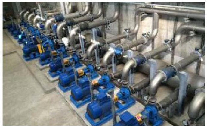
L'interno dell'impianto di potabilizzazione Est di Cremona
