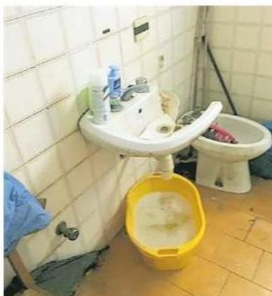
▲ Via Cogne Il degrado nel bagno
