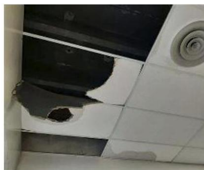
Gli uffici allagati e i pesanti danni alla struttura con il controsoffitto che ha ceduto per le infiltrazioni di acqua dal tetto
