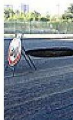
Cavalcavia Il cedimento in via Tukory
