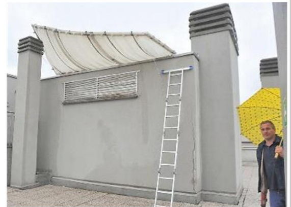
PROBLEMA La tettoia danneggiata al civico 1 di via Torre
