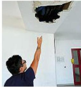
Degrado | cedimenti nel soffitto
